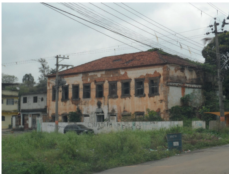
Imagem 2: casarão histórico em Paracambi. Seu estado de conservação é crítico.
