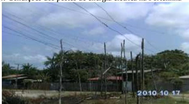
Figura 4: Condições dos postes de energia elétrica na Portelinha
