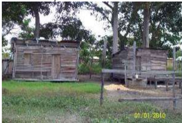
Figura 1: Vista das condições das casas na Portelinha
