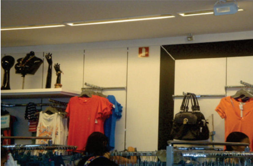
Foto 2 – Sinalização de Equipamento com altura inadequada.
