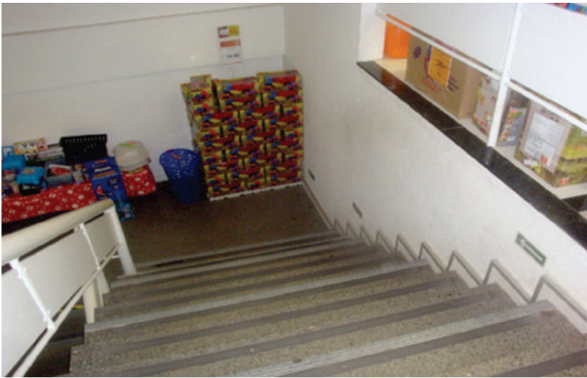
Foto 4 – Obstrução da sinalização da escada de emergência.
