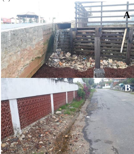
Figura 9 – Lançamento irregular de esgoto nas praias de Atalaia (A) e de Farol Velho (B)
