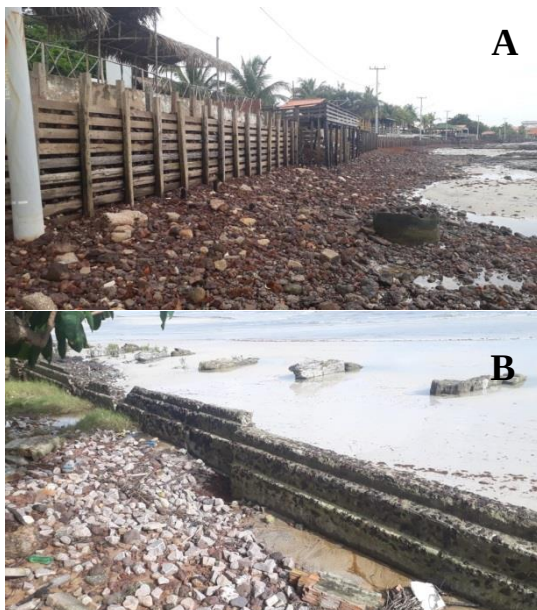
Figura 10 – Problemas erosivos nas praias do Farol Velho (A) e Maçarico (B)
