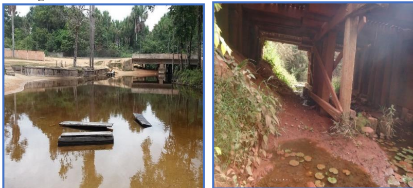
Figura 18 – Erosão e assoreamento em cursos d'água, na Bacia Hidrográfica do Rio Caeté
