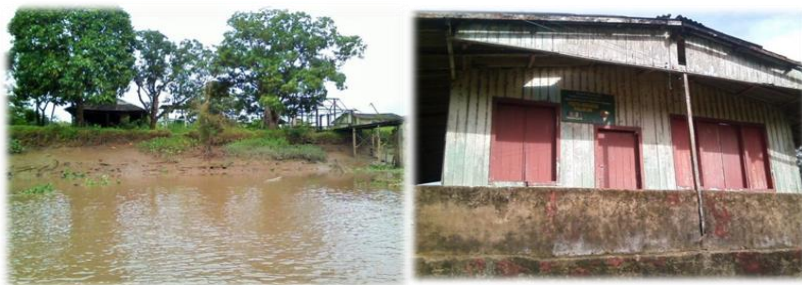
IMAGENS 02 e 03: Posto Indígena da FUNAI no Encruzo, abandonado desde 2005 e Posto Indígena da Aldeia Kumenê – Palikur, abandonado desde 2006. Fotos: Tadeu Lopes Machado – Janeiro de 2016.
