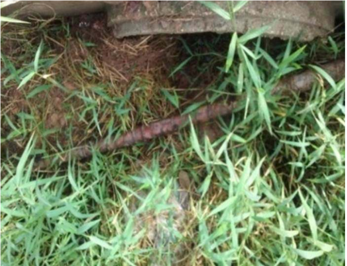
Figura 5: Tubulação obstruída no Igarapé Sucupira
