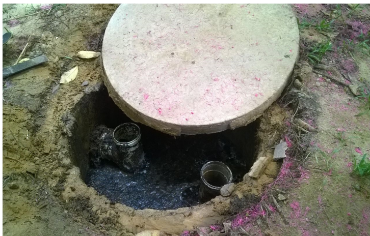
Figura 1: Tanque séptico do RU
