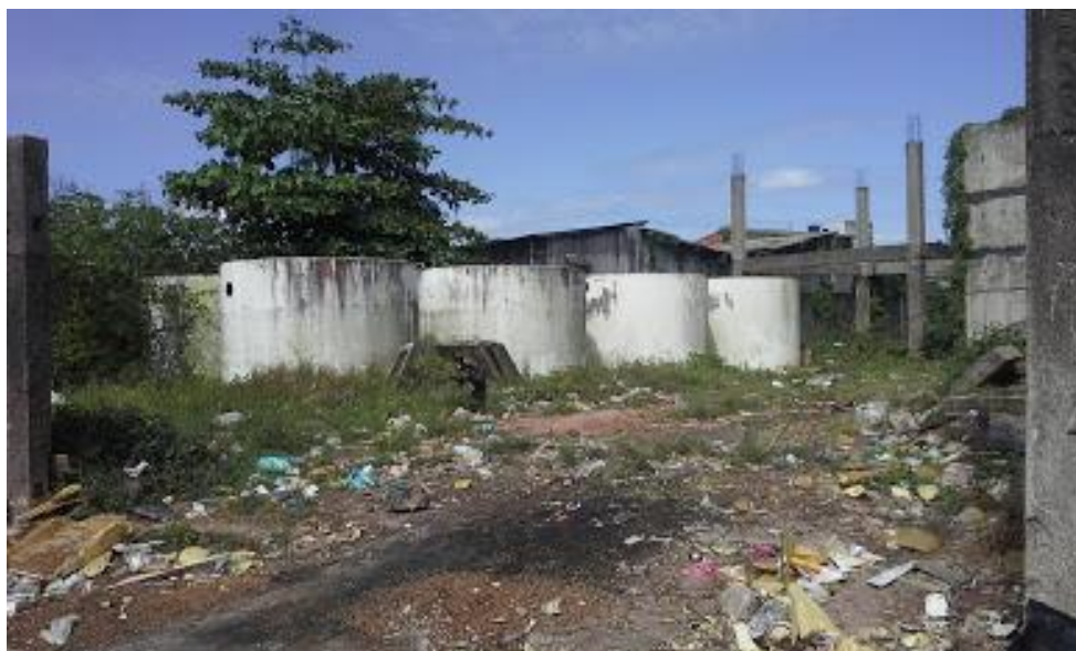
Fonte: MALHEIROS, 2017. Estação de Tratamento de Esgoto (ETE) abandonada.
