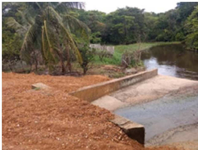
Figura 7. Despejo de esgoto no leito e aterro na margem direita do rio Jipuúba
