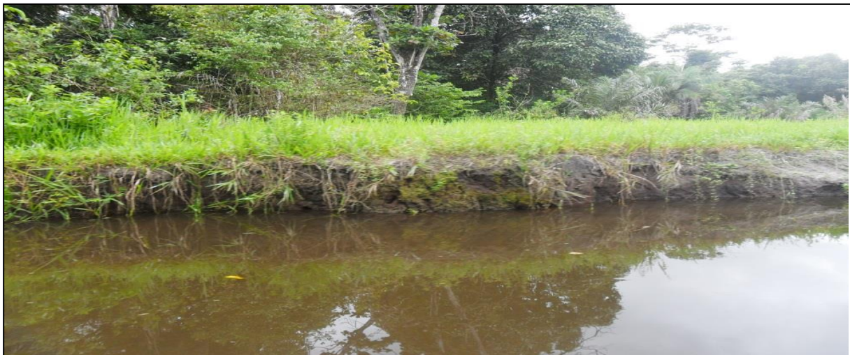
Figura 2: Processo de erosão da margem do rio Peixe-Boi
