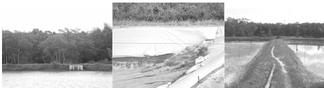
Figura 7. (a) Talude de viveiro próximo ao mangue, (b) Viveiro revestido com rochas e lonas, (c) Talude do viveiro com nenhum tipo de revestimento, próximo à mata capoeira.
